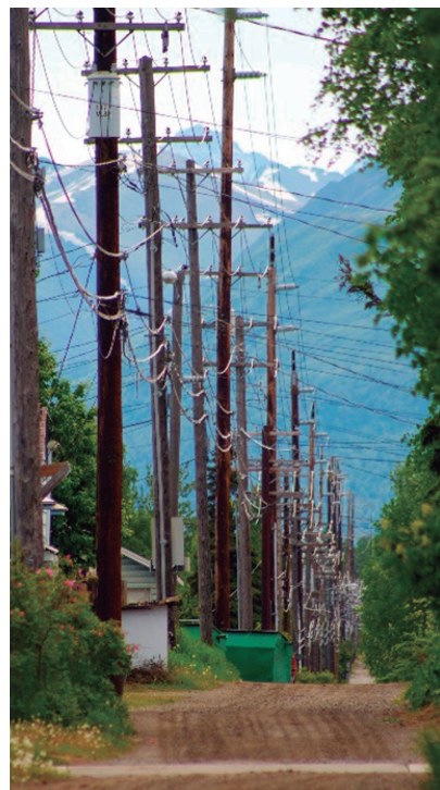
Figura 19: Para a manutenção de cabos em redes de distribuição nos níveis de tensão 13,8 kV, com sistemas energizados, é fundamental conhecer e aplicar o conceito de resistência de isolamento.
