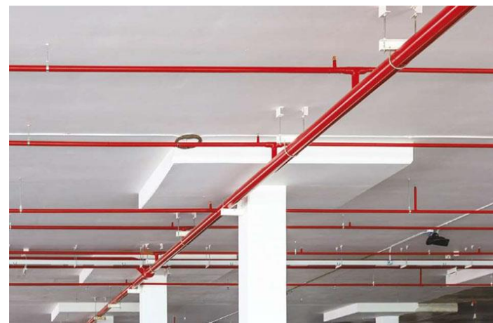
Sistema “sprinkler” em salão
