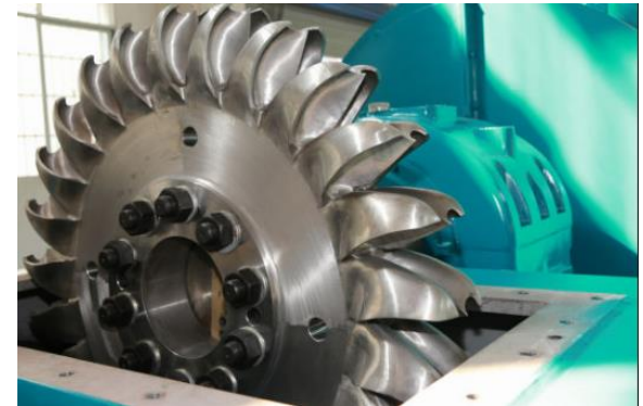
Conjunto Turbina-Gerador Elétrico
